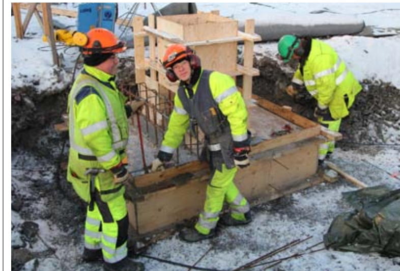
Seth Andersson, Mattias Nurkalla och Mats Nyström från NCC gjuter plintarna till nya krossverkstaden.
