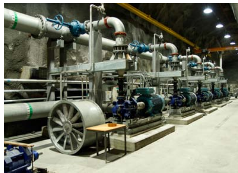
Fyra pumpstationer med likadan utrustning förbättrar underhållet.
