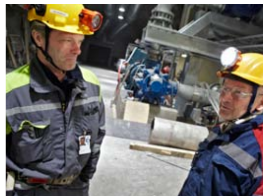
Hans Engberg, projektchef, och Åke Skoglind, projektledare fasta anläggningar, inspekterar bygget av en ny pumpstation.
